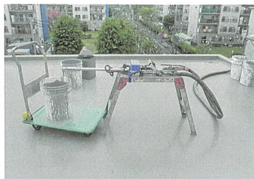
▲ハンドミキシング設置状況
