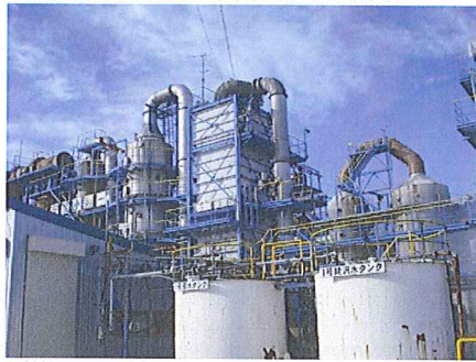
二次・三次燃焼炉
