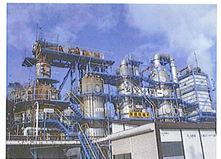
冷却塔 洗浄塔
