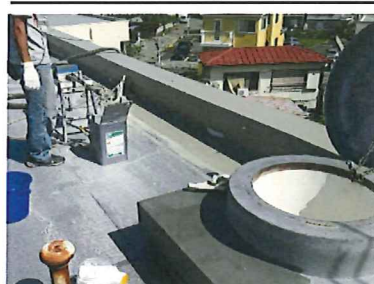
丸ハッチ900パイここから荷上げ不可
