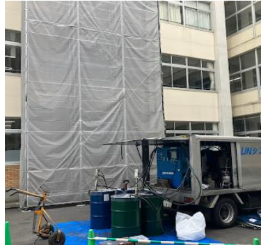
前回と同じ場所:北棟にUNマシン設置
